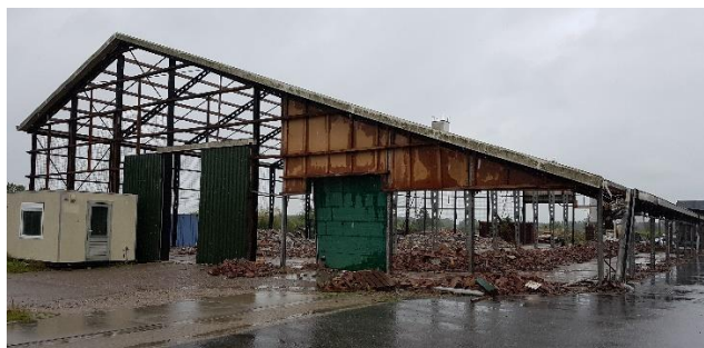
Foto: laatste gebouw KI station is inmiddels gesloopt en maakt plaats voor gebouwen 7a, 7b en 7c
